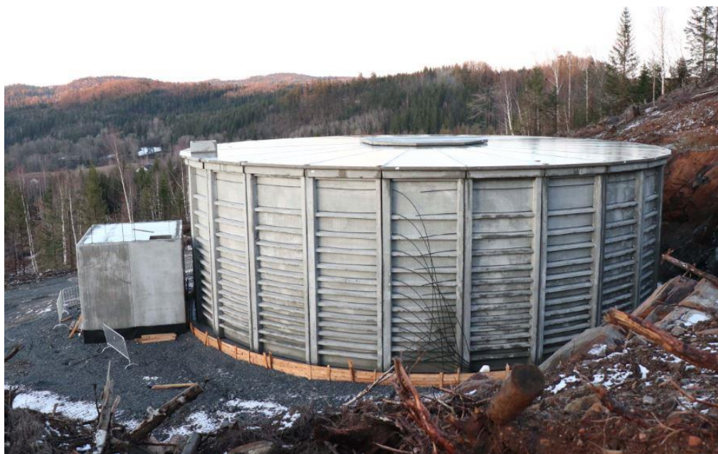
Figur 21, bilde av nytt høydebasseng til vannforsyning.
