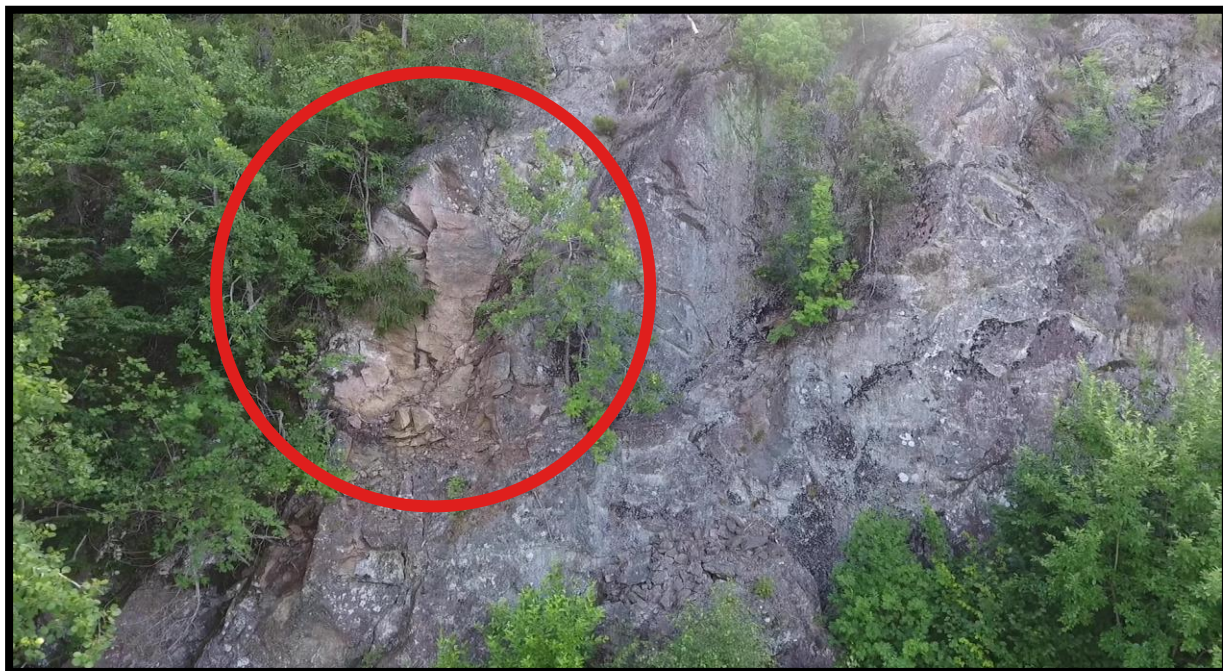
Figur 10. Løsneområde for et mindre steinsprang like ved kryss fv. 406/rv. 41.
