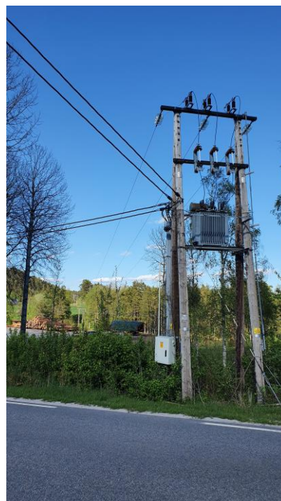
Figur 7 Trafo og strømmast i sentrum
