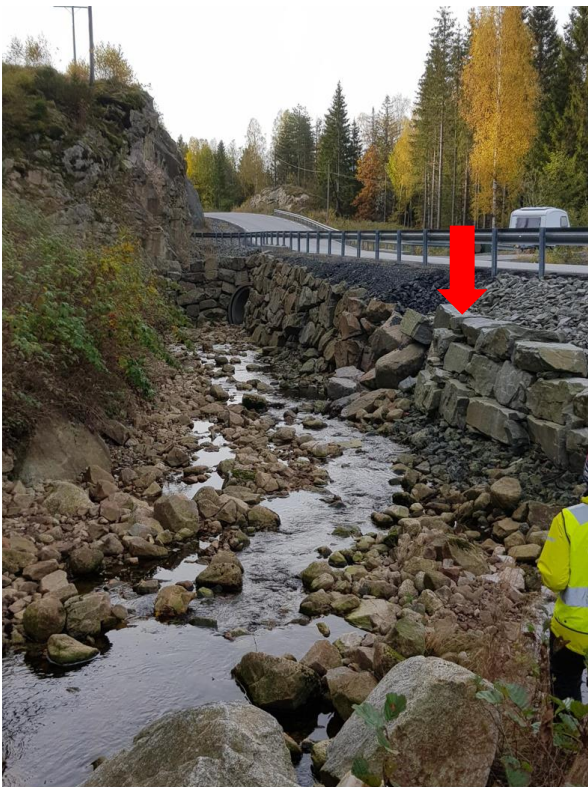
Figur 5. Tørrmur ble skadet og vegskulderen gled ut, se rød pil.
