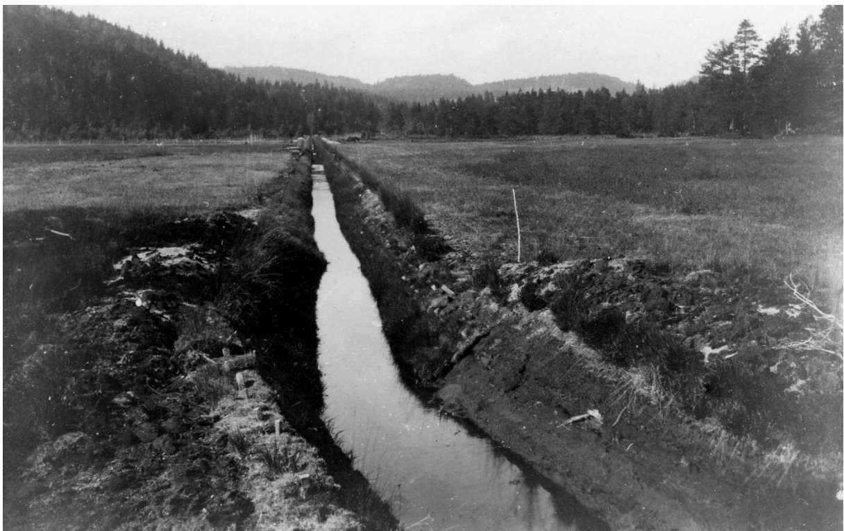
Den store kanalen for Temmervåbekken i nordenden av Myra. Bildet er tatt i 1922 da kanalen ble gravd med handemakt.
